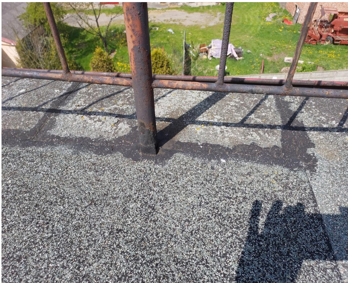
Fot. 5. Struktura dachu strażnicy oraz skorodowana barierka.
