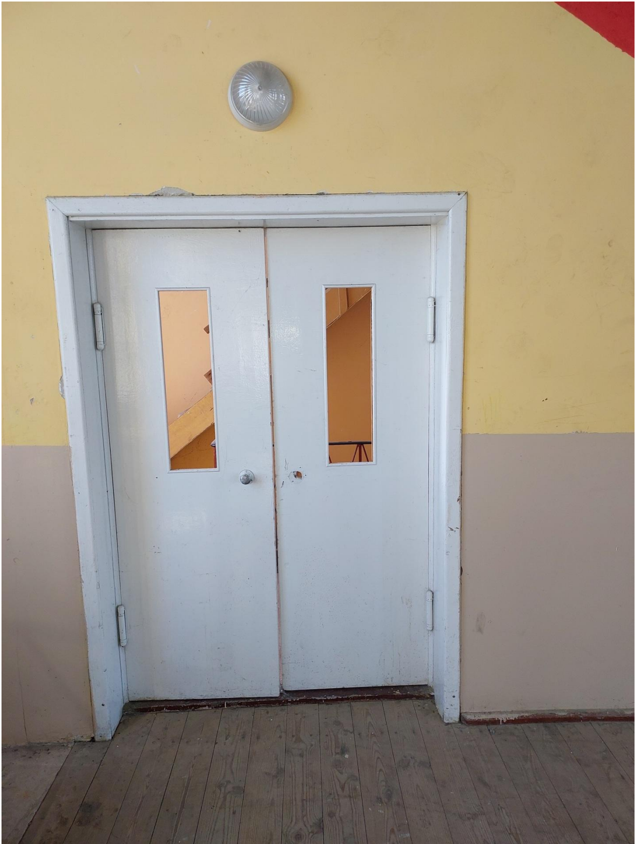
Fot. 10. Drzwi wahadłowe przeznaczone do wymiany, pom. nr 1.1.
