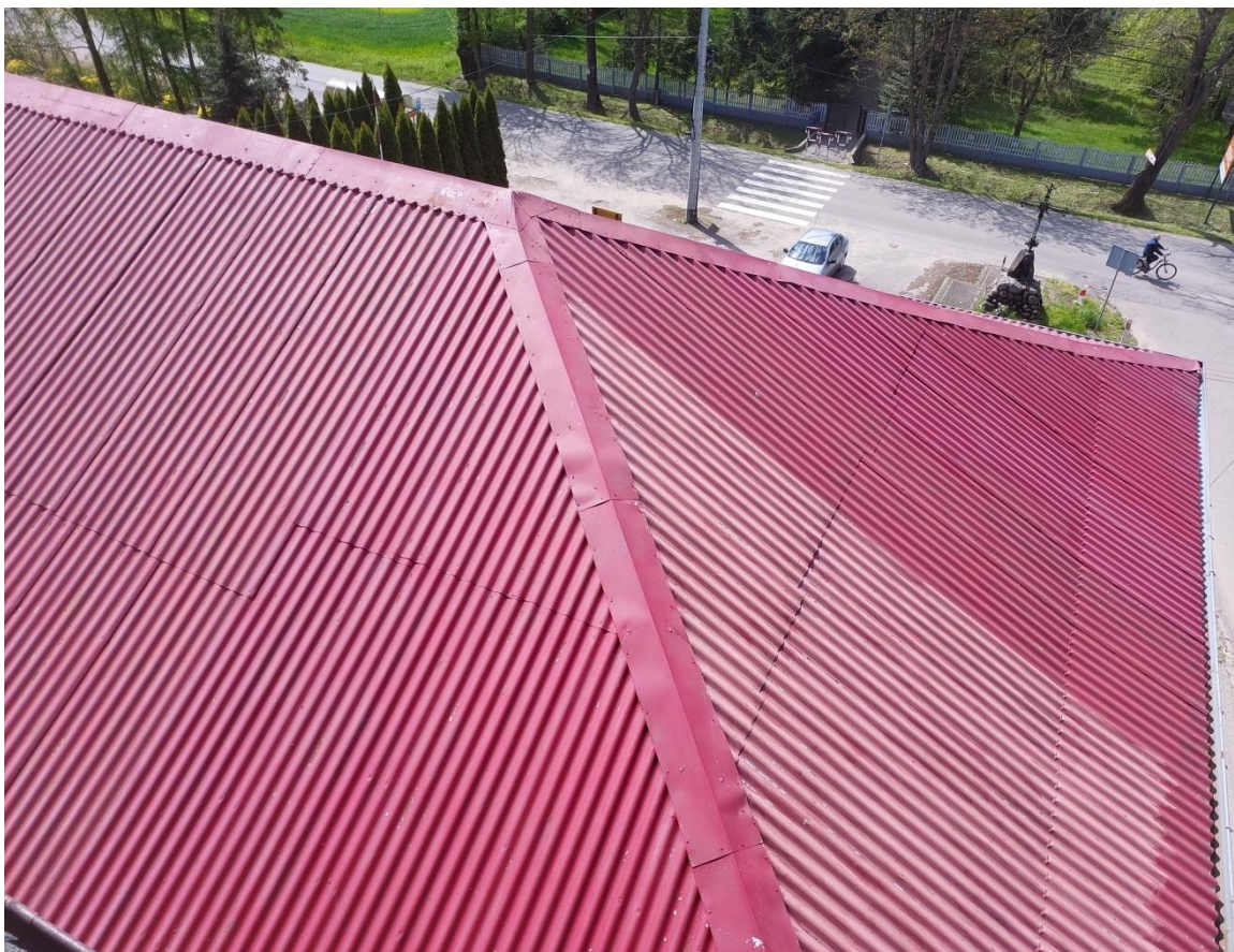
Fot. 1. Istniejąca struktura dachu. Jest trwała lecz nie estetyczna.
