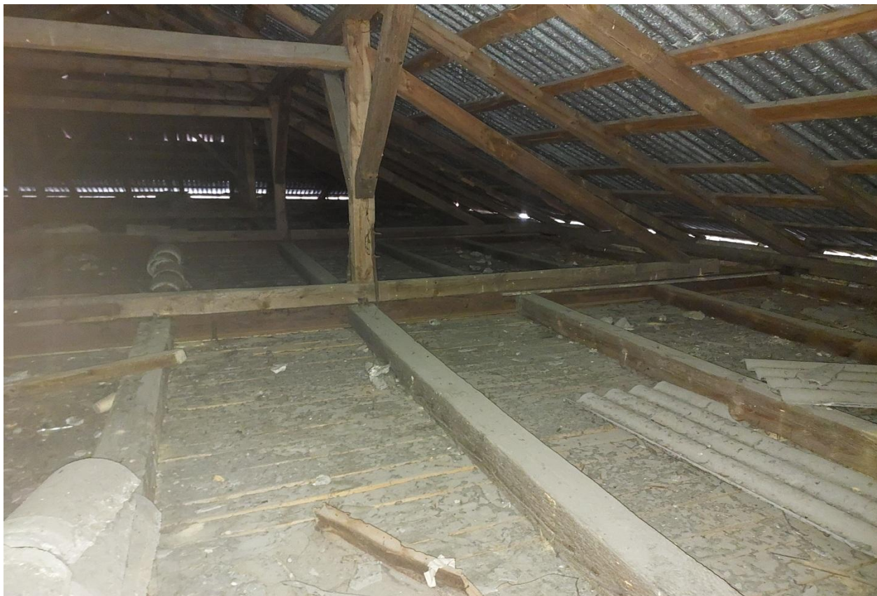
Fot. 6. Stan techniczny więźby dachowej. Struktura drewna jest trwała i sucha.
