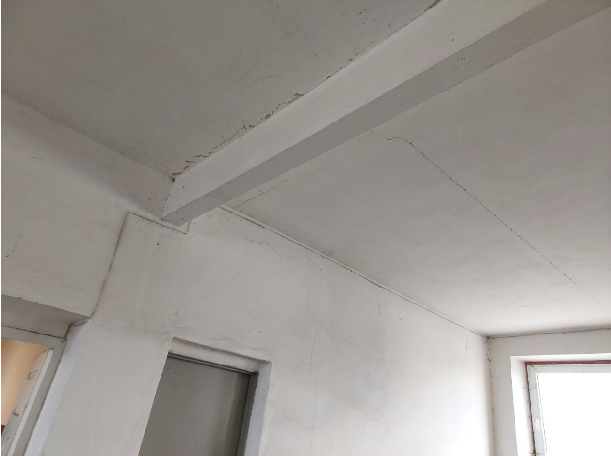
Fot. 9. Uszkodzenie stropu w pom. nr 0.9.
